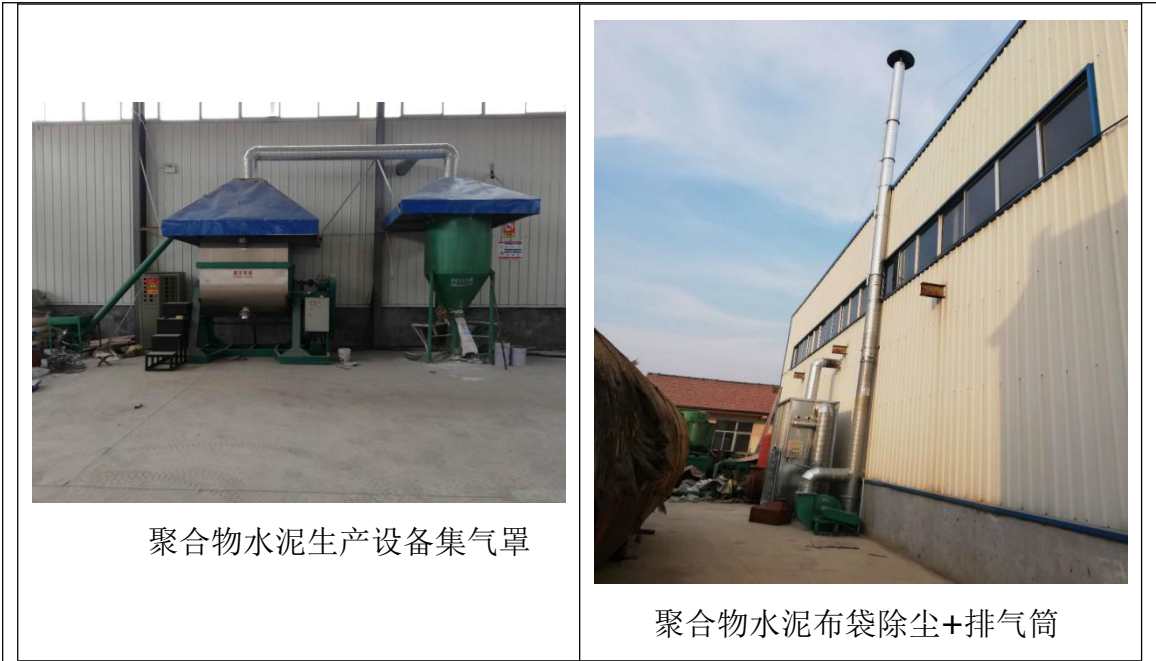
图 3.2 废气治理设施照片
